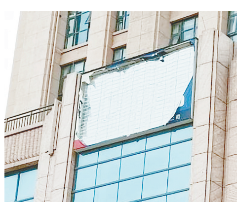
嵩山西支路与会展路交叉口向南约30米路西,建业壹号中心墙体上的广告牌破损。
