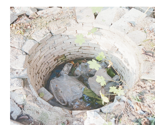
邱山路与淞江路交叉口向南约110米路东,荣盛锦绣江南小区门口绿化带内井盖缺失。
