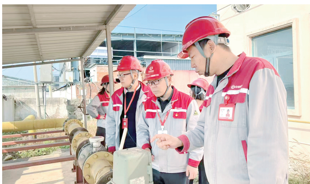
漯河中裕燃气总经理毛海军(右二)到门站检查设备设施运行情况。
