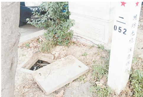
黄河东路与韶山北路交叉口向东约10米路北，井盖移位。
