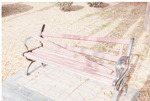
宝塔山路与长江路交叉口向南约100米路西，游园内座椅破损。
