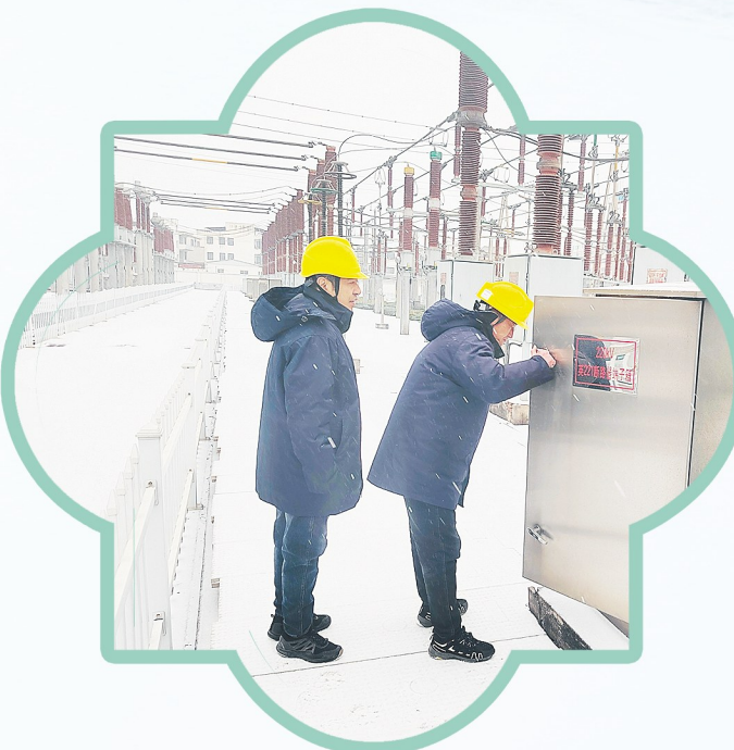
1月19日，运维人员在英章变电站巡视设备。 本报记者 姚晓晓 摄
