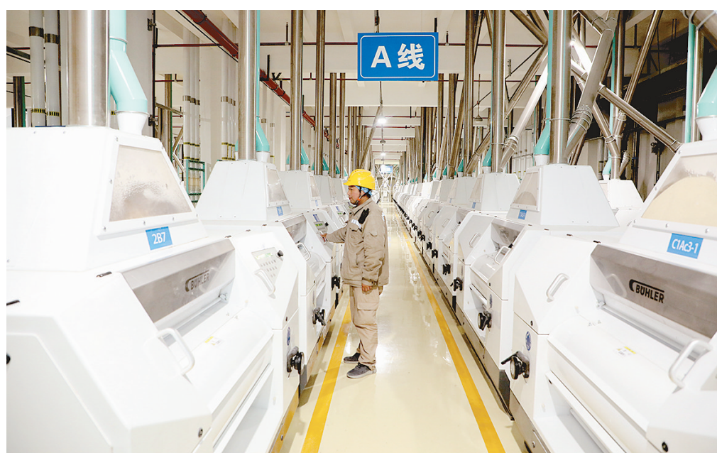
中粮漯河公司按需生产，可以用小麦制成160多种面粉，为各类食品企业提供面粉定制服务。图为中粮漯河公司新上的日产750吨面粉生产线。
