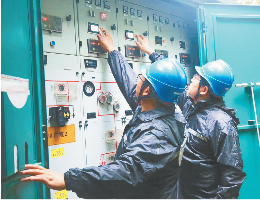
8月11日，国网漯河供电公司组织人员对市区配网柜进行巡查，确保供电设备安全可靠运行。 魏建北 摄
