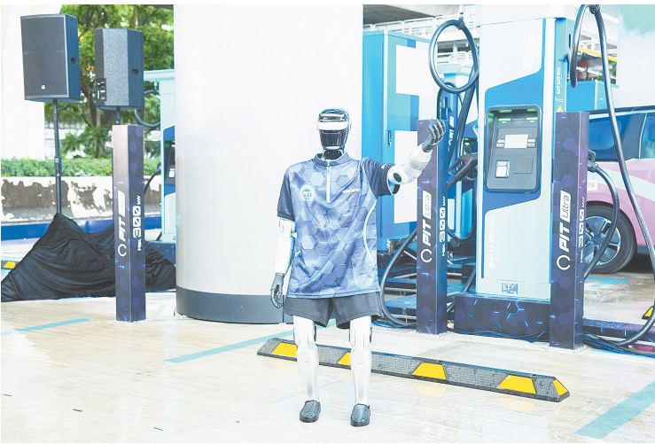
香港首个由加油站全面转型为高速专用充电站的项目8月31日正式启用。充电站位于九龙湾启福道，站内提供20个快充车位，配备5部充电功率达600千瓦的主机。图为8月31日，机器人在充电站启用仪式上表演。
